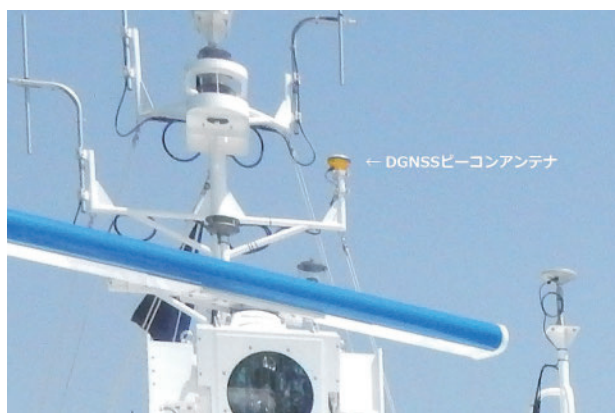
Photo 8. DGNSS beacon receiver antenna 写真 8. DGNSS ビーコン受信機アンテナ
