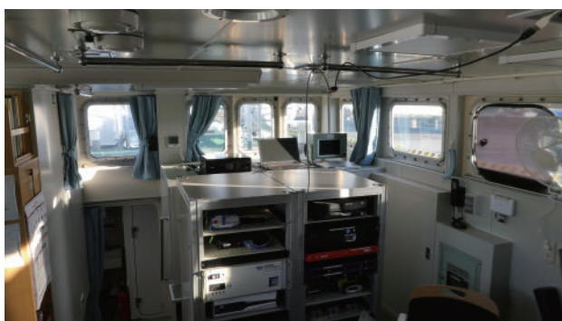
Photo 16. Equipment rack in observation room 写真 16. 観測室 (機器ラック)
